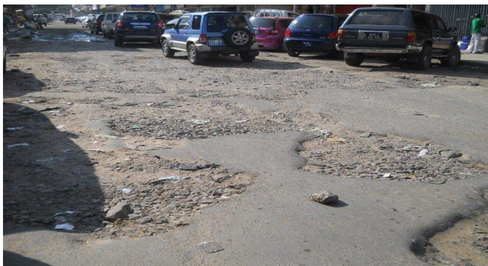
Figura 2-2 Estrada esburacada, distrito de KaMpfumu, bairro do Alto-Maé A
